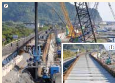
仁ノ海岸堤防改良工事 (①圧入完了後、②圧入施工中)
