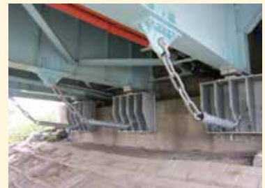
パワーチェーン(チェーン型落橋防止装置)
