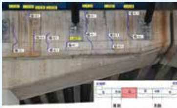
橋脚梁部測定結果(ひび割れの幅・長さ)
